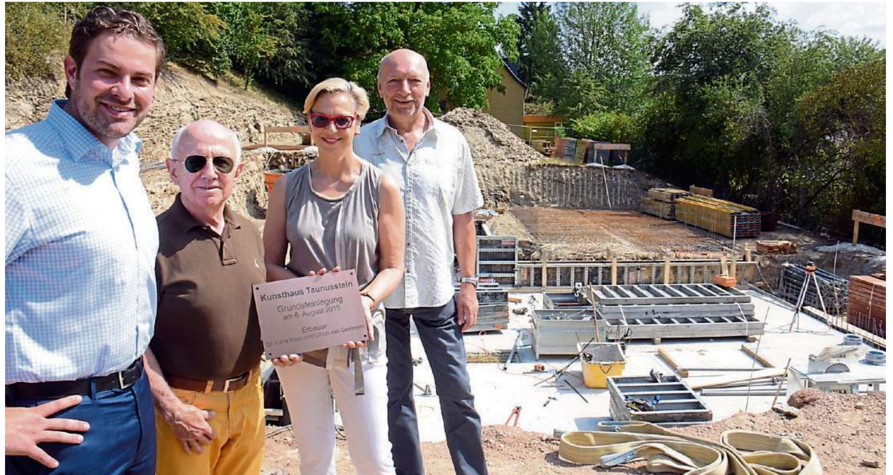
Plakette statt Grundstein für das Kunsthaus Taunusstein (von links): Bürgermeister Sandro Zehner, Ulrich van Gemmern, Irene Haas und der Niederlibbacher Ortsvorsteher Dieter Weiß vor der Baugrube, die die Arbeiter mit einem Felsen gleich zu Beginn vor ungeplante Probleme gestellt hat. Foto: wita/Martin Fromme
